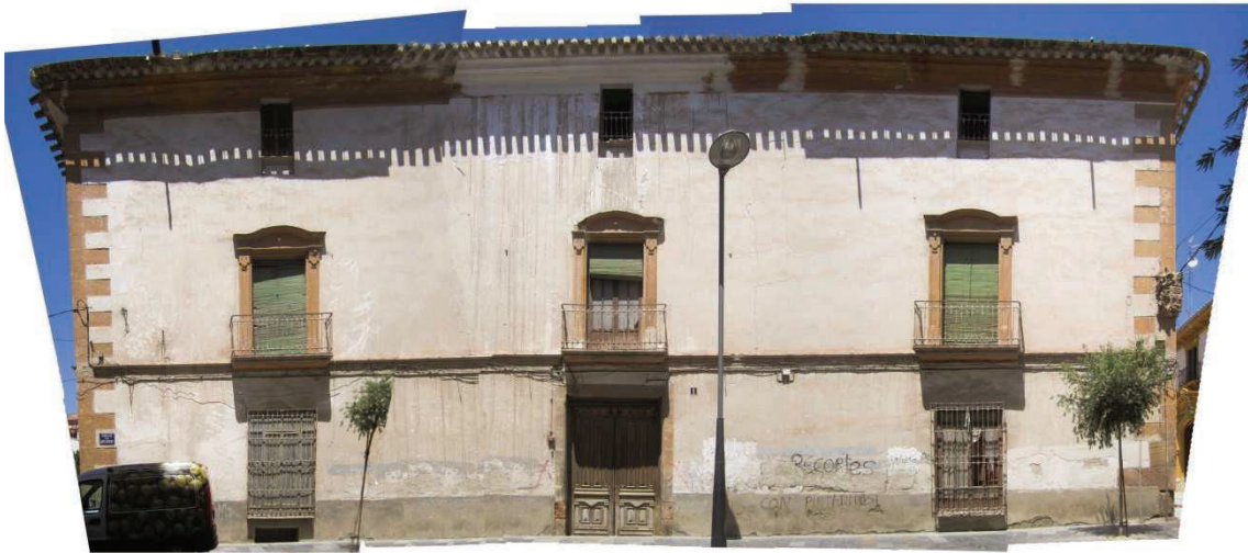
Ilustración 1. Fotografía de la fachada principal de la Casa de Los Arcas, por Rosario Baños Oliver. Junio 2013, Calle López Gisbert, Lorca
